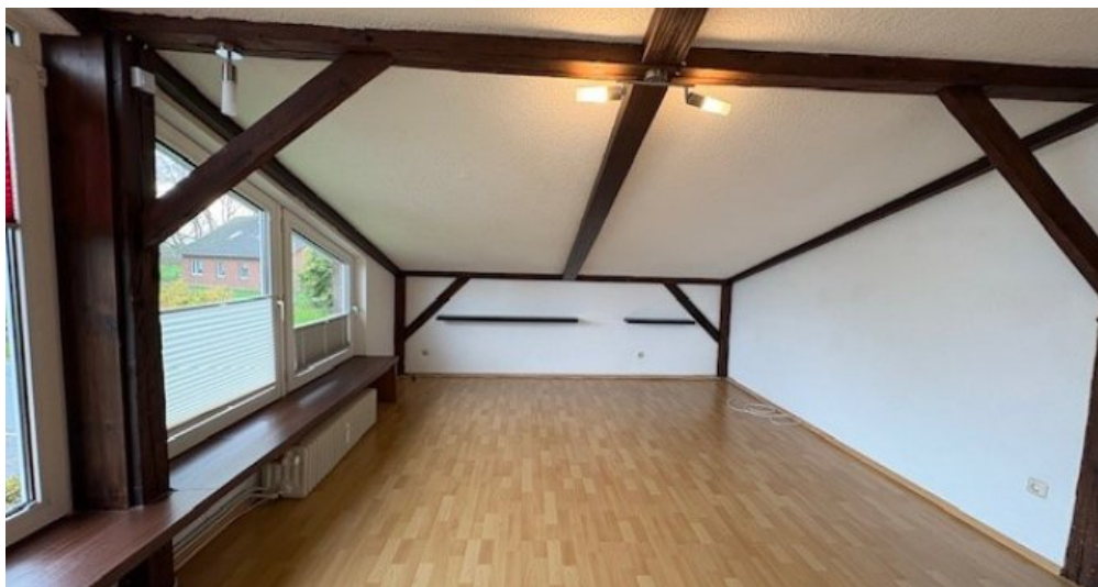
Lounge Bereich Strübbel
